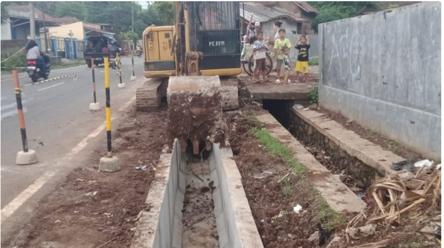
Proyek Drainase Jalan Pandeglang - Labuan Diduga Tak Sesuai Spesifikasi Kontruksi
